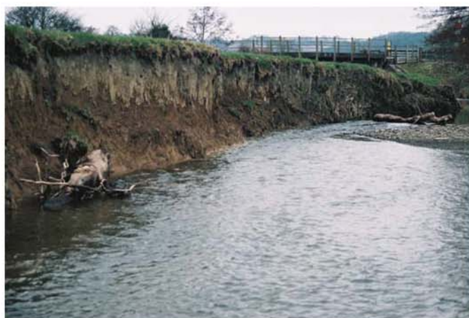
Above : Erosion on the Dulais
